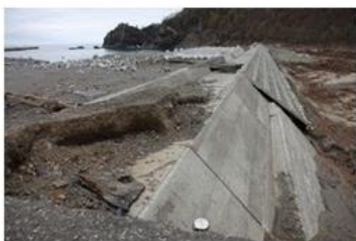
小本町の崩れた堤防と湾
